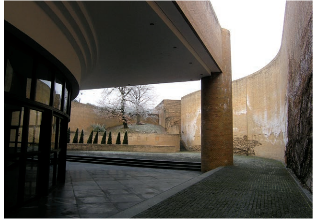
Zid pokraj velike dvorane s uočljivim bjelinama
